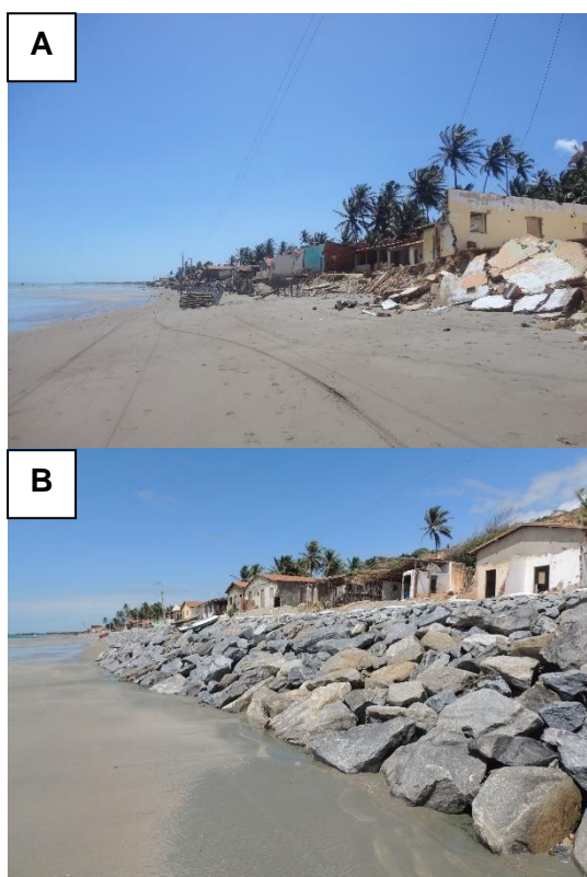
Figura 3 – Erosão costeira na praia de Barreiras em Icapuí, Ceará. A) Destruição das edificações localizadas na alta praia, em 2015; B) Enrocamento de pedras construído, em 2016, para proteger as edificações na praia de Barreiras.
