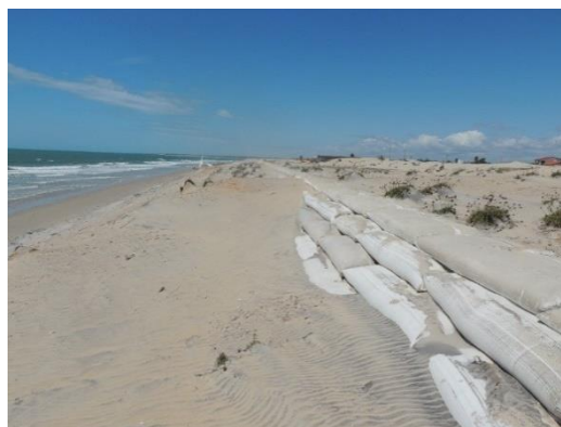
Figura 4 – Obra de proteção costeira do tipo Bagwall instalada na praia de Parajuru no município de Beberibe. Nela, os sacos têxteis são preenchidos com concreto fresco e empilhados em forma de escadaria.
